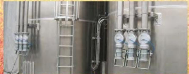
Vannes à manchon
