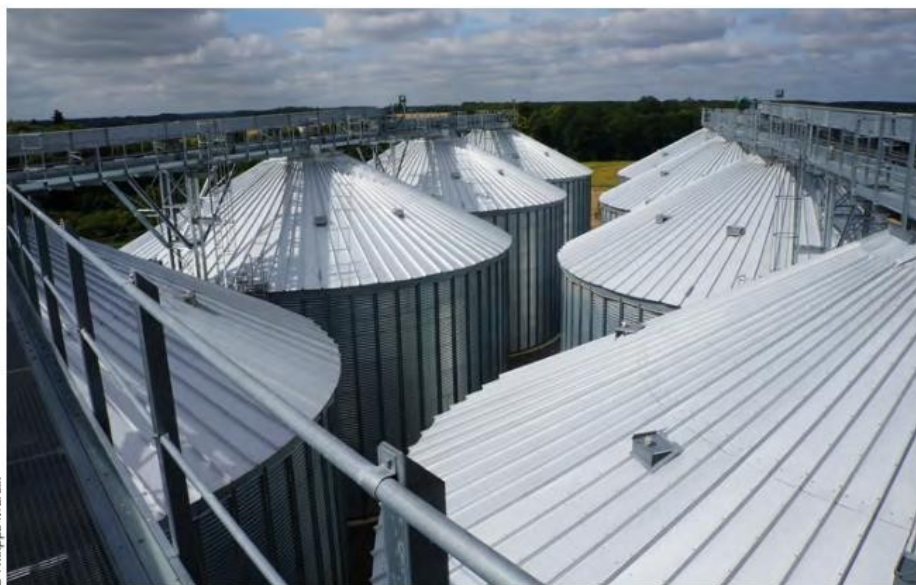
→ Les toitures coniques des 8 cellules intègrent, chacune, 8 supports de sondes thermiques, indispensables à la bonne conservation des grains.
